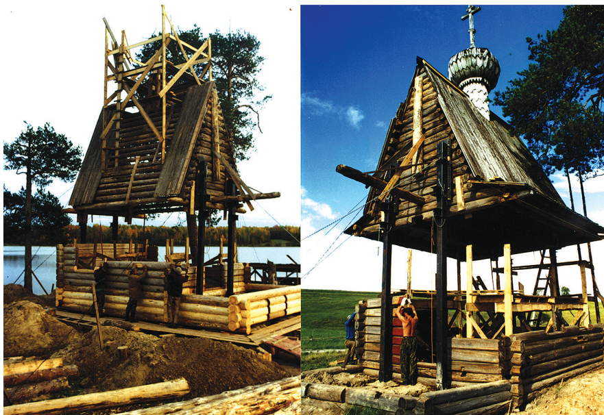
Ил. 6. Реставрация часовни Сочествия Св. Духа в д. Глазово методом лифтинга. 1998 г.
